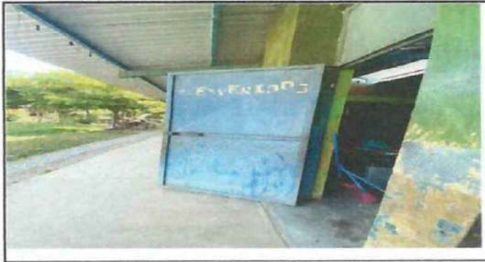
Foto 6: Sustitución de puertas en aulas debido a mal estado.
